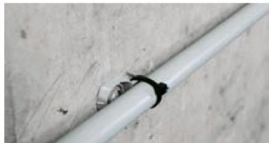
Pružná nebo pevná kabelová vedení s kabelovými příchytkami
